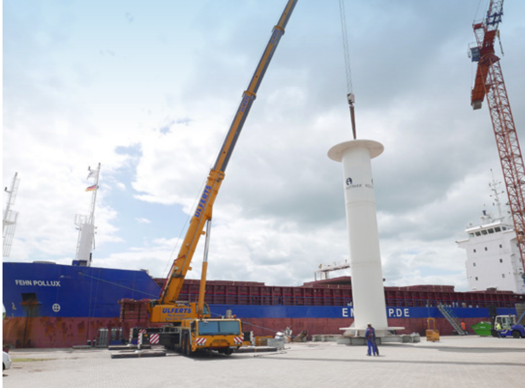
Bild 1: Das Frachtschiff „Fehn Pollux“ wurde mit einem Flettner-Rotor nachgerüstet. Hier wird gerade der Rotor in der Schiffswerft SEC in Leer mit einem Schwerlastkran auf das Schiff gesetzt und installiert. (Foto: Martin Bönsch)
